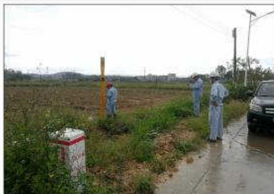
全线阴保桩测试
