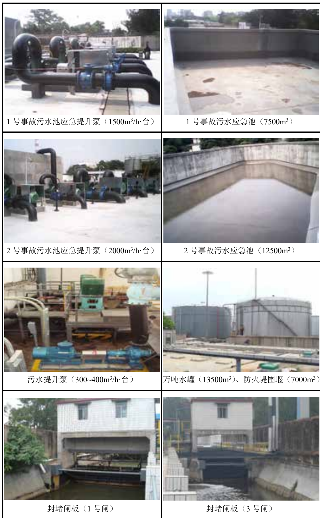
图 4-5 事故污水三级防控系统部分主要设施设备实物图
