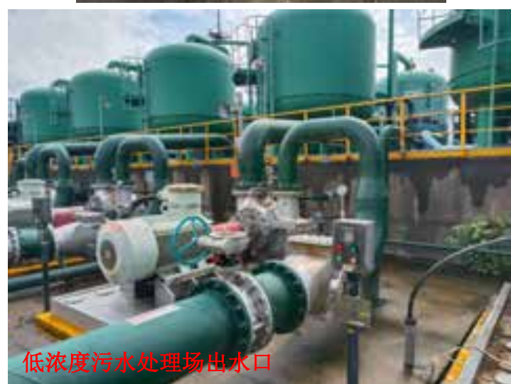
图 4-2 废水治理设施图片
