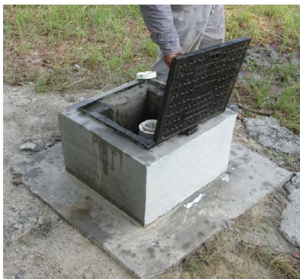
图 6-3 建成的地下水监测井
