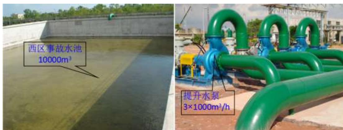
图5.6-1 化工厂区西区事故水池
